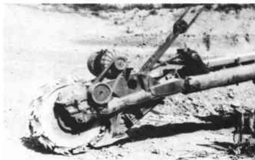
Рисунок 9 – Рабочее оборудование экскаватора ЭР-200ИК с бесковшовым ротором нижней разгрузки косого ступенчатого резания в забое кембрийской глины с числом ударов плотномера ДорНИИ 48-60
